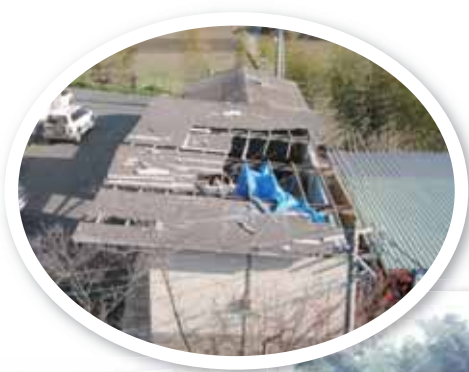
◀ 管内の台風による被害 (本所横倉庫)
