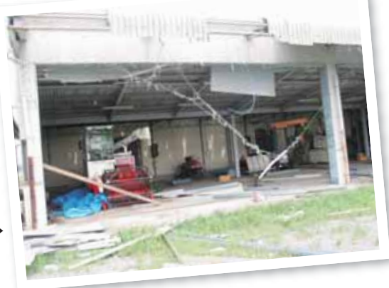
管内の台風による被害 (農業倉庫) ▶
