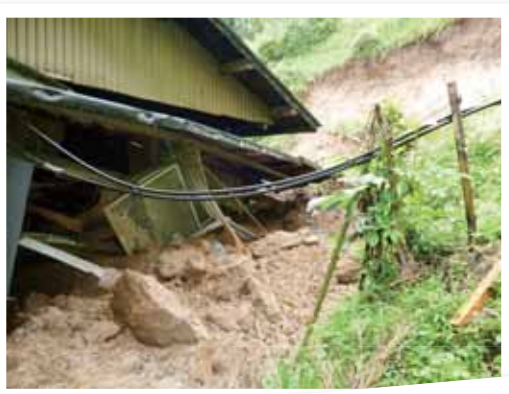
▲ 管内の集中豪雨による被害 (山都町)
